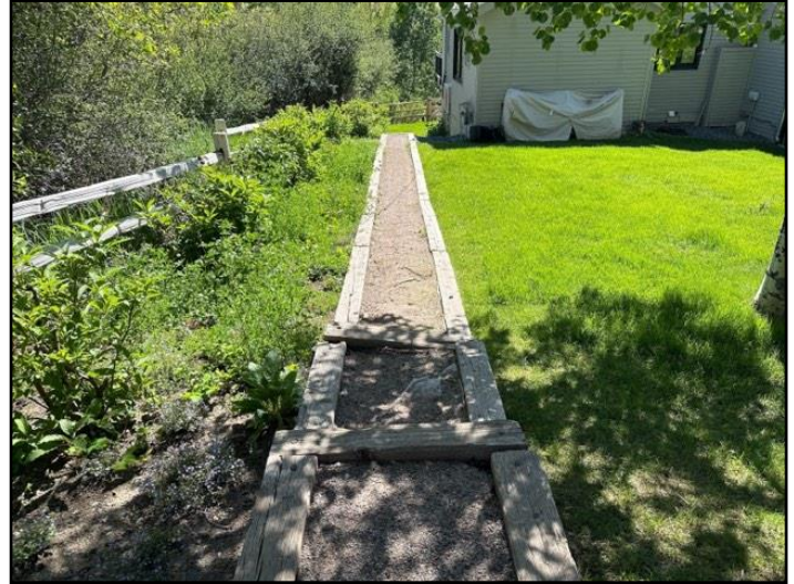
Uneven (trip hazard)
