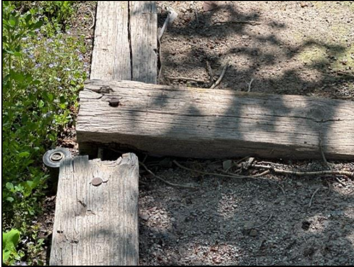
Uneven (trip hazard)
